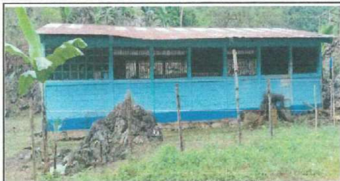
Foto1: En esta fotografía se evidencia la necesidad del cambio de techo
